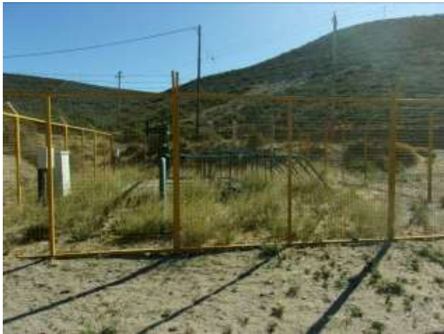
Foto III.B-18. Satélite inyector 12E, desde donde saldrá la futura línea de inyección. Vista hacia el N.
