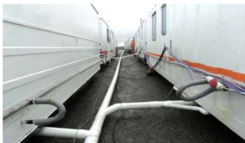
Foto III.B-34. Conexiones colectoras de efluentes crudos.
