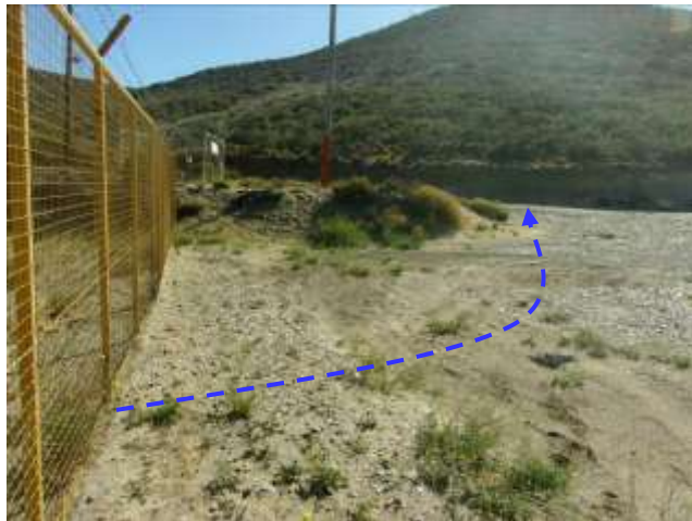
Foto III.B-19. Futura línea de inyección del pozo E-634 desde el satélite inyector. Vista hacia el N.
