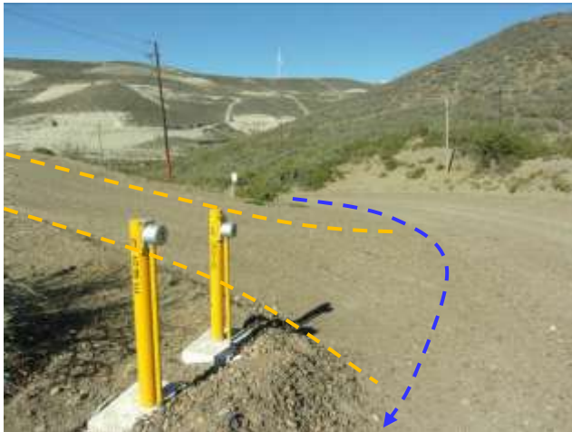
Foto III.B-24. Futura línea de inyección por margen interno de camino atravesando el camino de acceso del pozo E-92 (naranja). Vista hacia el SO.
