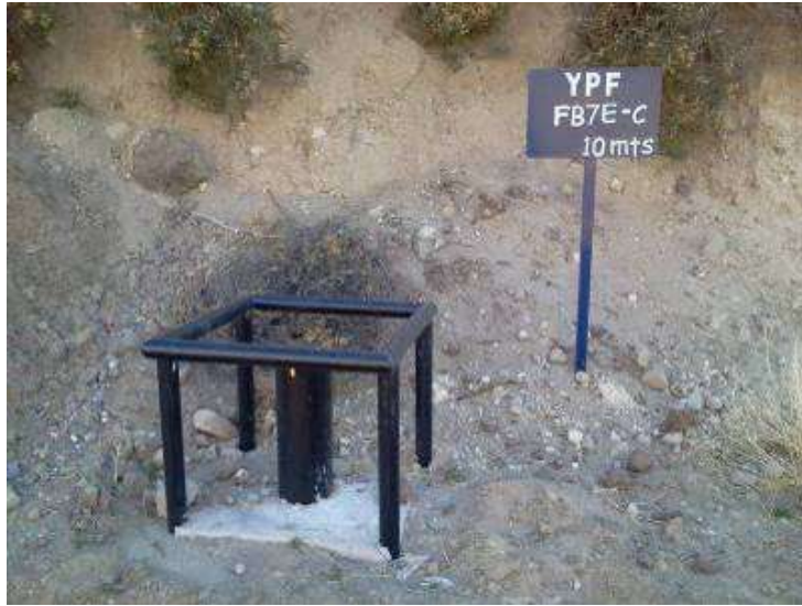
Foto IV.1-5. Freatímetro FB7E-C ubicado aguas abajo de la zona de tanques.
