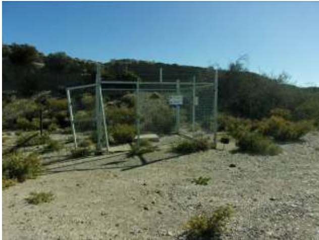
Foto III.B-12. Rejas en desuso de equipos eléctricos, se observa una platea de hormigón adentro de la misma. Vista hacia el N.
