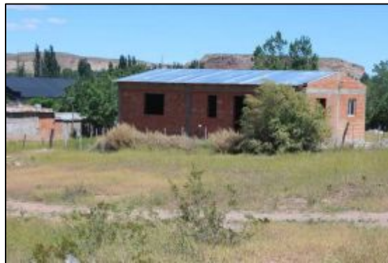
Imagen 16. Edificación en construcción al suroeste del sitio elegido para instalar la planta de almacenaje de GLP.
