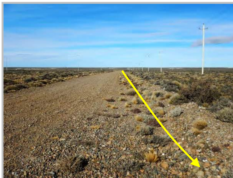
Figura 20: Traza del oleoducto por el lateral O del camino de acceso al pozo PJ-806. Vista hacia el Sureste.
