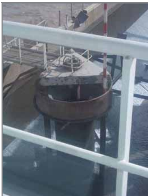
Figura 14. Sistema de rebalse.
