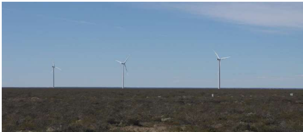
Fotografías 26. Aerogeneradores Parque Eólico Aluar Etapas I, II, III: Vista desde La Flecha
