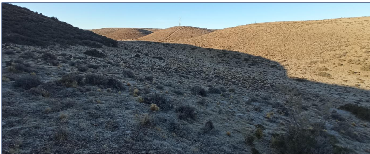
Imagen V.1 Línea de tendido eléctrica atraviesa sector de cañadones. Vista hacia el E-SE. (Lat. -45° 49' 23,8'' Long -68° 28' 07,47'').
