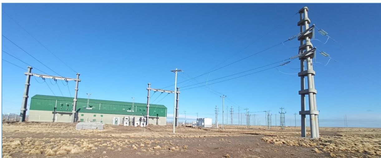
Fotografía V.70 Vista panorámica de la estación transformadora Oriental II, vista hacia el E.
