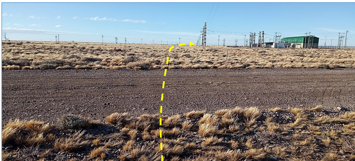
Fotografía V.68 La línea eléctrica cruza camino principal de yacimiento y arriba a la estación transformadora Oriental II. Vista hacia el N.
