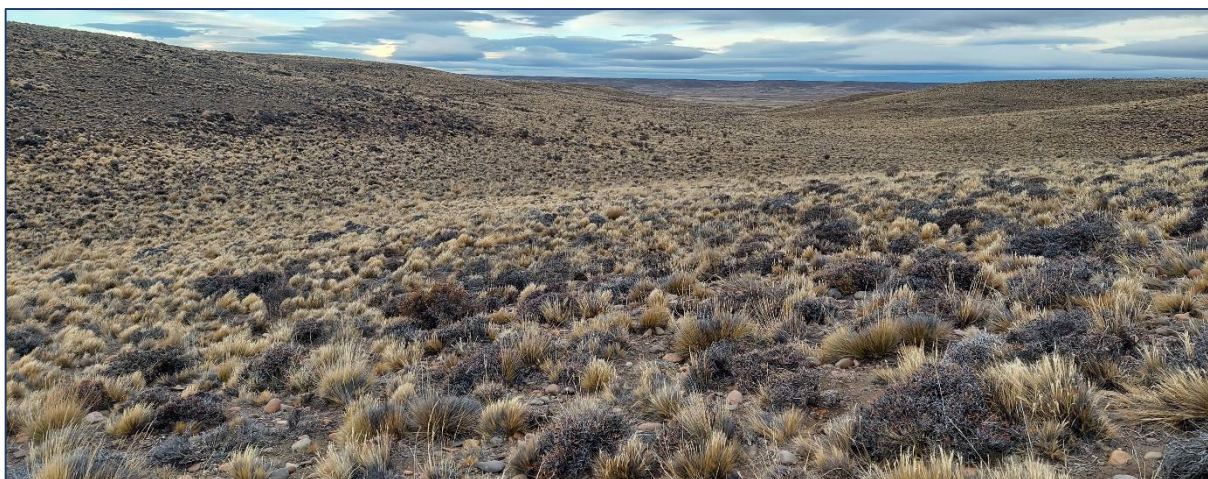
Imagen V.3 Línea de tendido eléctrico atraviesa sector de cañadones (Lat. -45^{\circ} 57' 57,6'' , Long -68^{\circ} 44' 05,4'' ).
