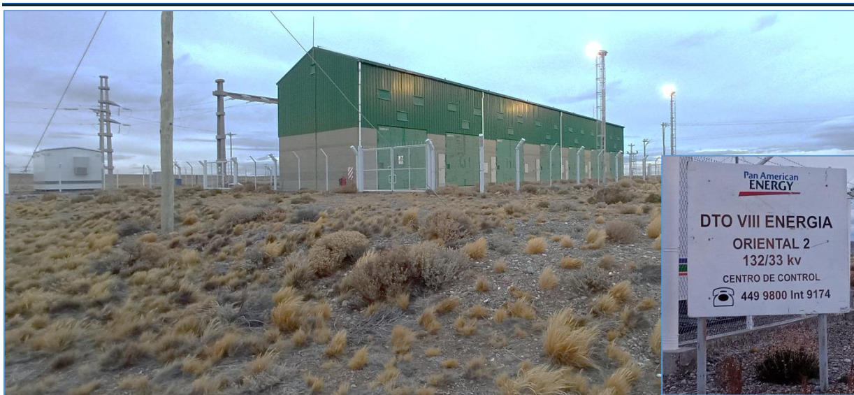
Fotografía V.71 Vista panorámica de la estación transformadora Oriental II, vista hacia el NO. Se observa cartelera identificatoria.
