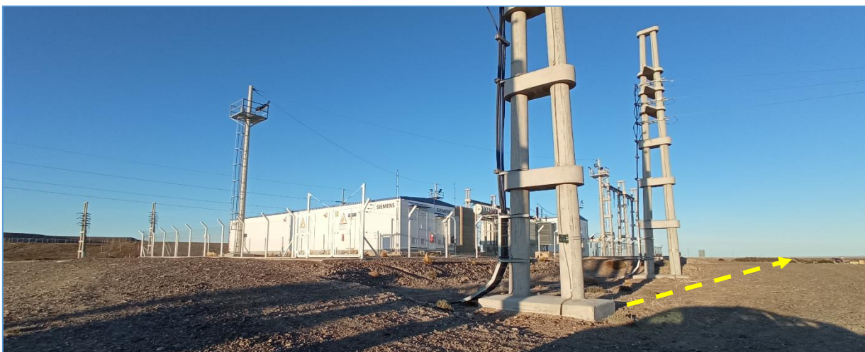
Fotografía V.11 Línea eléctrica inicia desde ET_R2 hacia el O-SO.
