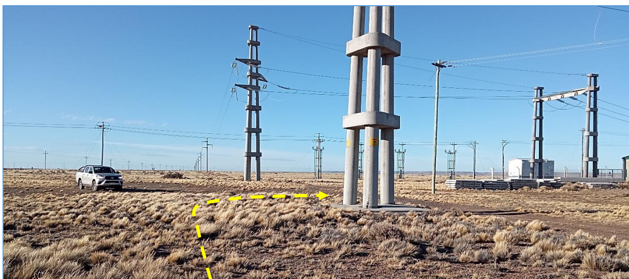
Fotografía V.69 La línea eléctrica arriba a la estación transformadora Oriental II, vista hacia el N.
