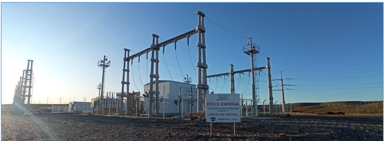
Fotografía V.10 Estación transformadora Resero II. Se observa cartel de identificación.
