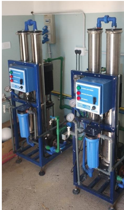
Fotografía 18. Sistema actual de osmosis inversa para el establecimiento.
