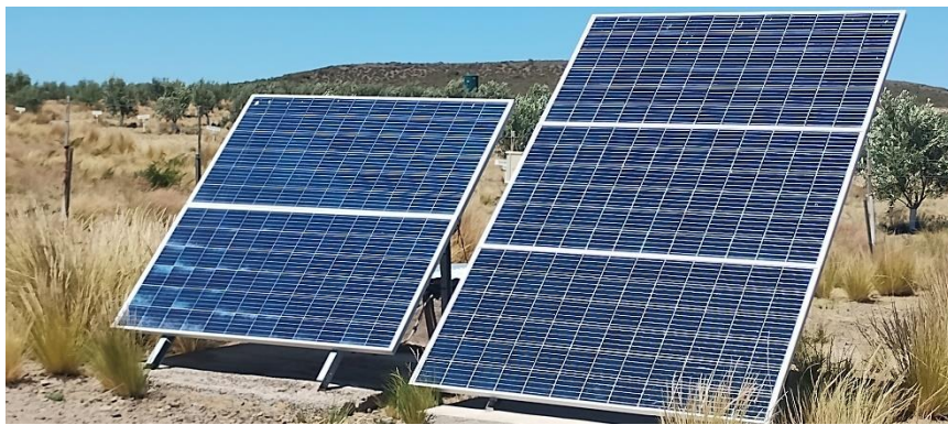
Fotografías 16 y 17. Abastecimiento actual mediante paneles solares
