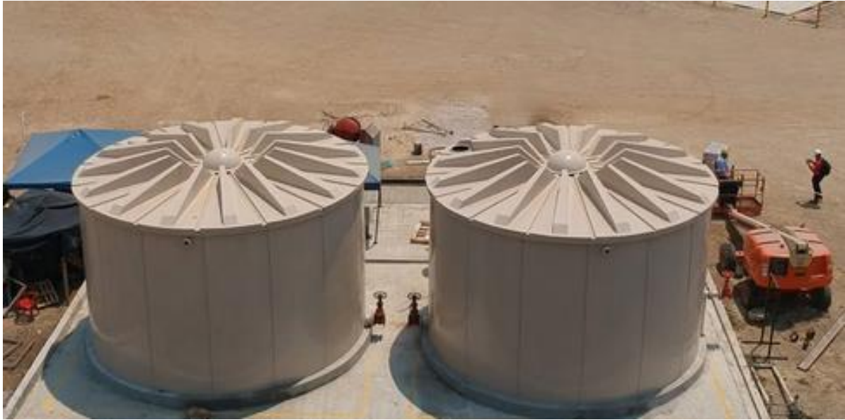
Figura 11. Tanques de almacenamiento. Fuente: EISI SA Water & Service Solution
