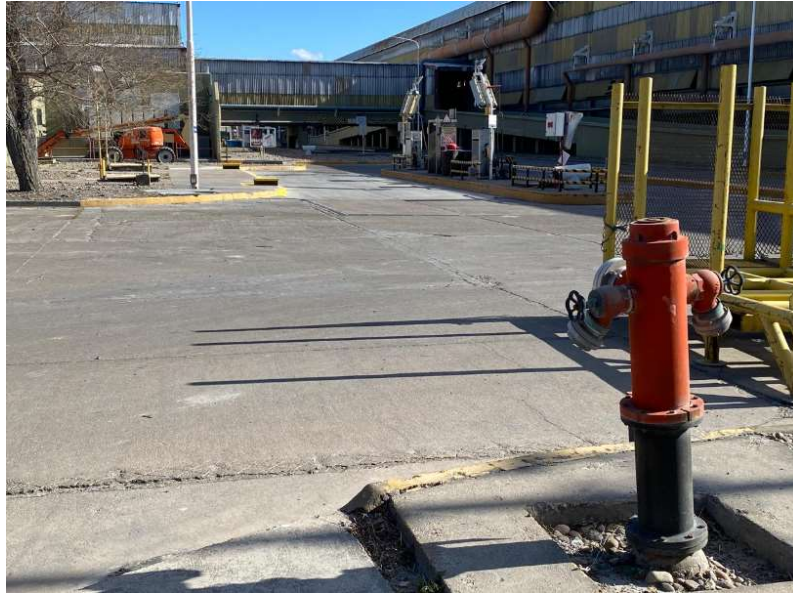
Figura N°42: Imagen de uno de los dos hidrantes ubicados en la Estación de Combustible de Primario.
