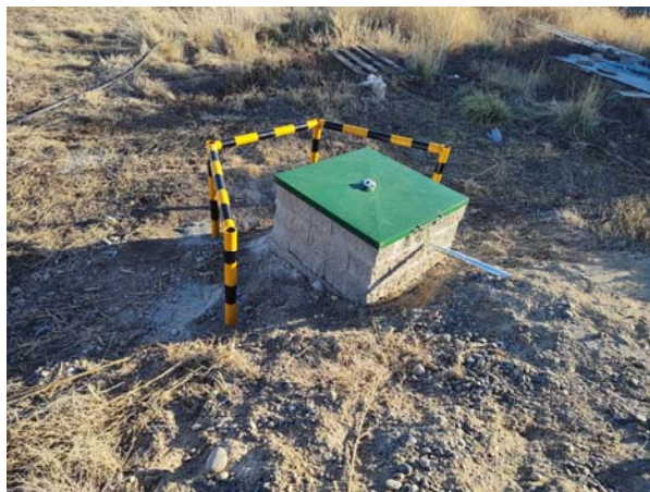
Foto 3: Caseta de perforación y bombeo.
