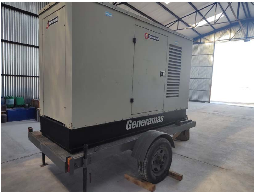
Imagen 10: Futuro generador a instalar para contingencia.
