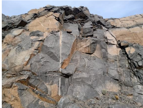
Imagen 15: Frente de cantera, detalle de la perforación del barreno. También se observan grietas modernas y discontinuidades teñidas de óxidos.
