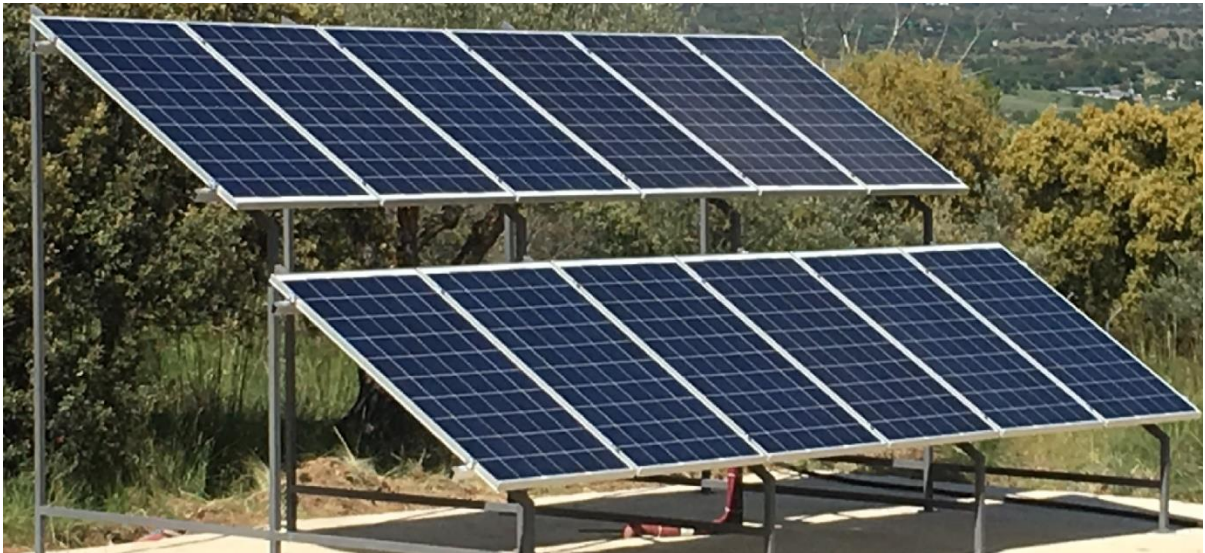
VISTA DE UN SISTEMA DE SERVICIOS GENERALES
