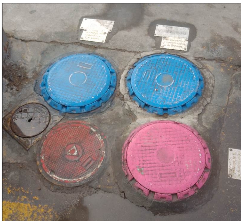
Fotografía 4: Detalle descarga remota de los tanques 1, 2 y 3.
