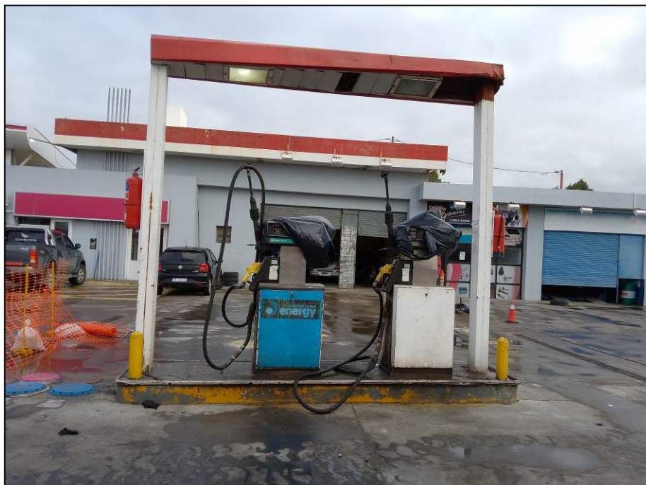
Fotografía 4: Detalle Isla y descarga remota que dan a calle Cardenal Cagliero.
